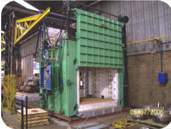
Horno de tratamiento térmico
